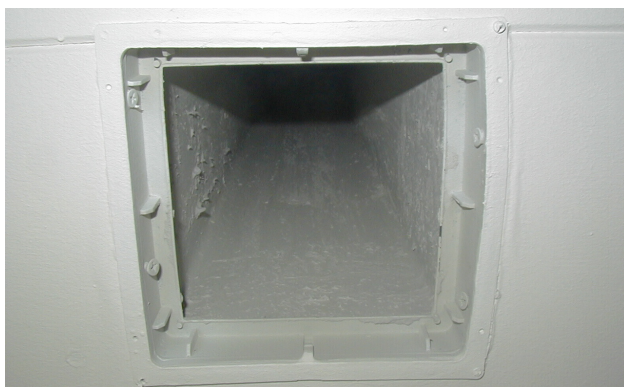
Fig. 4 Kanalen er behandlet med TM Coating ECO - Therm Energy.
